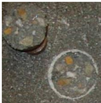
Adhésion 1190 psi Béton arraché
